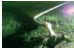
Umgefallener Straßen- beleuchtungsmast noch in Funktion
