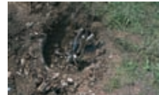
Abgetrenntes Erdkabel unter Spannung
