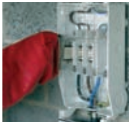
Hausanschlusskasten mit Niederspannungs-Hochleistungssicherungen (NH-Sicherungen)
