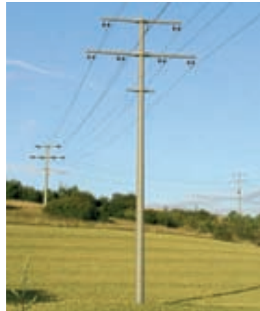
Masthöhe ca. 10 – 16 m 20 kV-Doppelleitung
