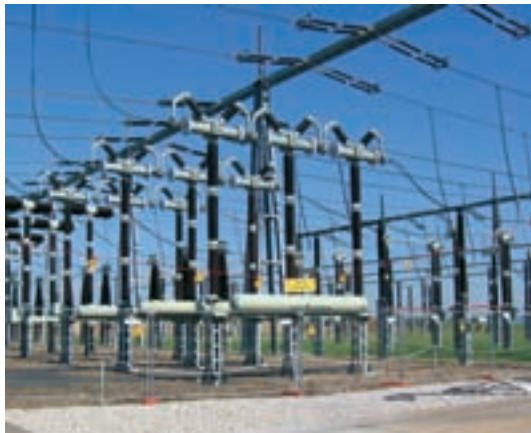
Leistungsschalter in einem 380 kV-Schaltfeld
