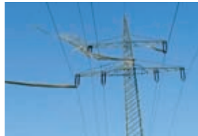
„Spargelfolie“ in 110 kV-Freileitung
