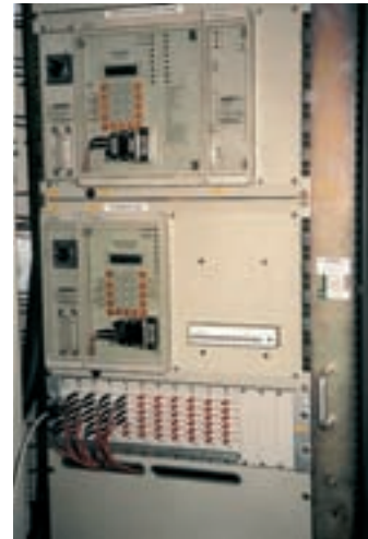
Netzschutz moderne digitale Ausführung
