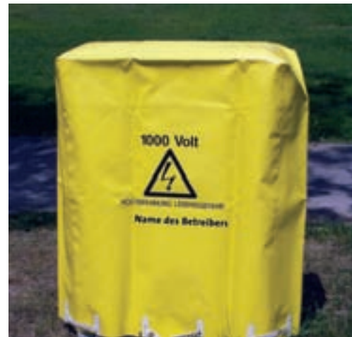
Beschädigter Kabelverteilerschrank isolierend abgedeckt
