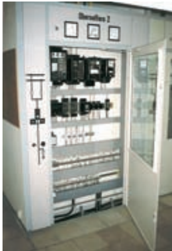
Netzschutz elektromechanische Ausführung
