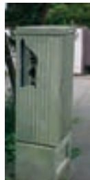
Beschädigter Kabelverteiler- schrank
