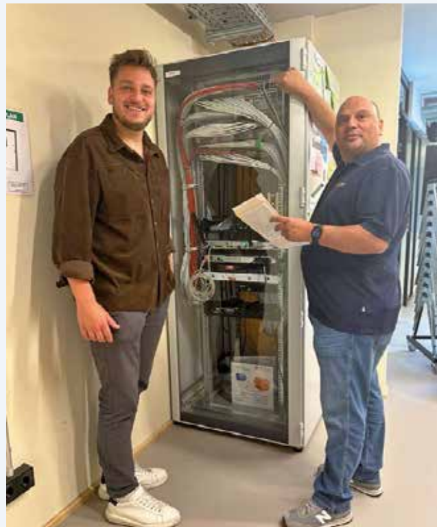
Das Herzstück des Projekts – die Technik
